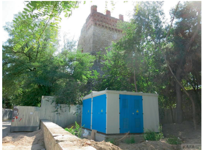
Фото з російської соціальної мережі «Вконтакте». На фото зображена незаконно побудована трансформаторна підстанція, яка встановлена в забороненій для будівництва зоні в безпосередній близькості від пам'ятки архітектури.
