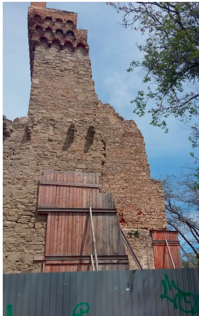
Фото з російської соціальної мережі «Вконтакте». На фото зображена стіна Башти Костянтина, яка підкріплена дерев'яним щитом, як спосіб припинення руйнування пам'ятки архітектури.
